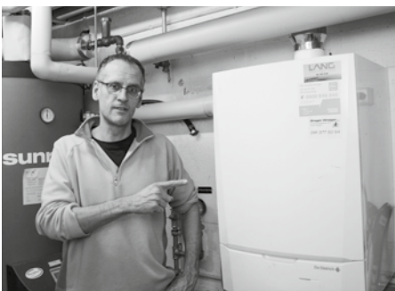
Thomas Scherer zeigt die neue Gasheizung im Keller seines Hauses an der Libellenstrasse.
